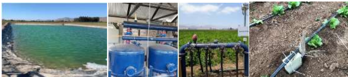
Figura 8. Infraestructura para el riego en parcela Pan de Azúcar.
