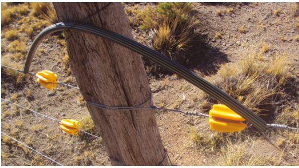
Imagen 15: La manguera protege al cable que lleva la corriente para que no se descargue al pasar a través del poste. Esta manguera esta curvada hacia abajo para que no se le acumule agua de lluvia en su interior. Para el alambre que lleva la puesta a tierra no es necesaria la manguera pero si es necesaria la unión de los alambres a través del poste.
