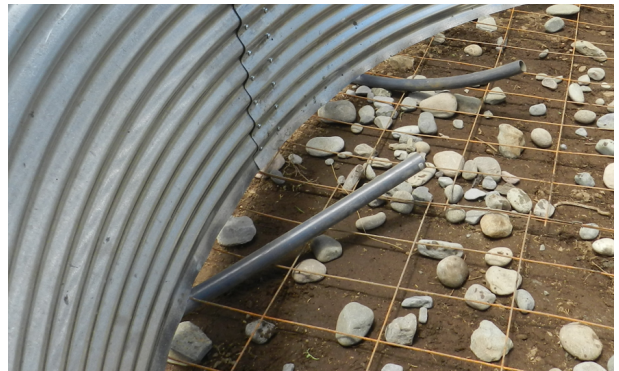
Imagen: Colocación de manguera negra para el desagote y salida de agua.
