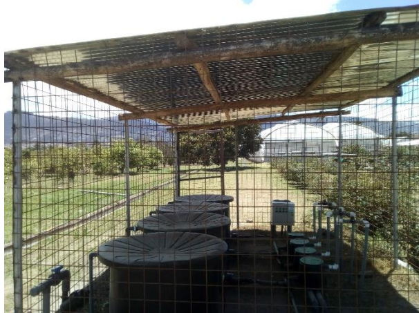
Gráfico 14. Sistema de bombeo para fertirrigación automatizada, Granja Tumbaco, INIAP, Ecuador
