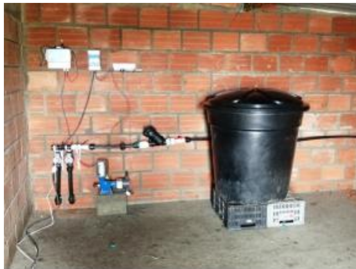
Gráfico 10. Conjunto de tanque, filtro, electroválvulas, bomba dosificadora y controlador.
