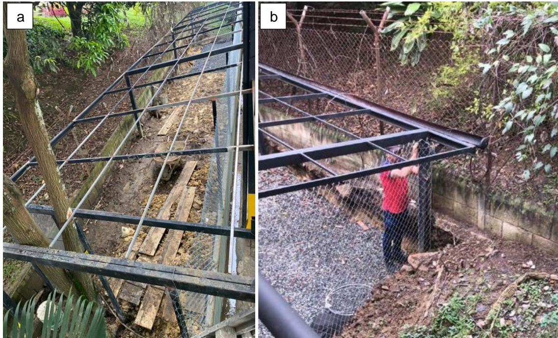
Gráfico 2. Proceso de Construcción de Vivero CIB para producción de plantas aromáticas a) ubicación de bases y vigas del vivero b) encerramiento de vivero cubierto.
