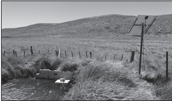
Figura 4: Módulo de panel solar y bomba funcionando en el Campo Experimental Pilcaniyeu de INTA (enero de 2019).
