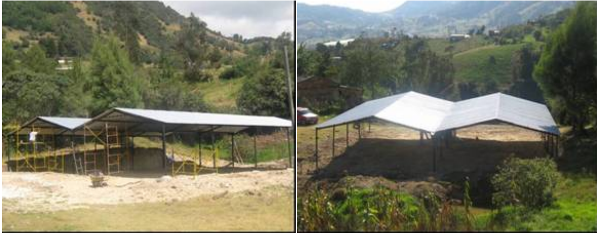
Fotografías 55. Vista general de la planta
